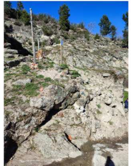
Foto n.º 3. Pormenor da falta de consolidação entre os elementos que compõem o muro.
