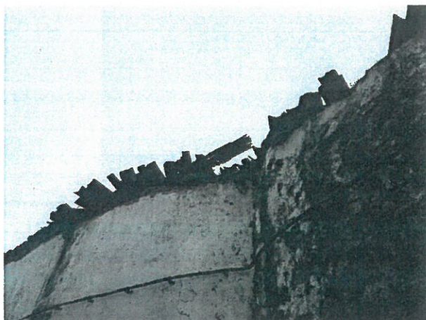
Foto 6. Elementos soltos da cobertura em risco de queda para a via pública.
